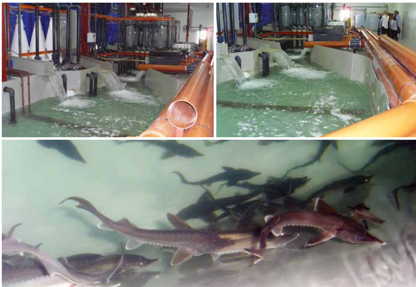
De översta bilderna visar filterrummet som innehåller bassänger för genomluftning, ozoniseringstankar och biologiska filter.
