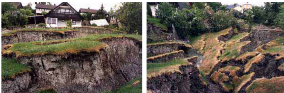
Bild 4. Skredet i Vagnhärad - östra delen mot Påskvägen. Foto: J Lindgren, SGI, 1997.
